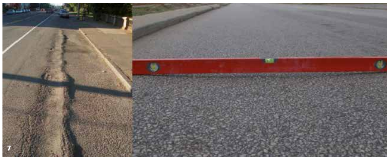
7. Esempi di deformazioni permanenti
